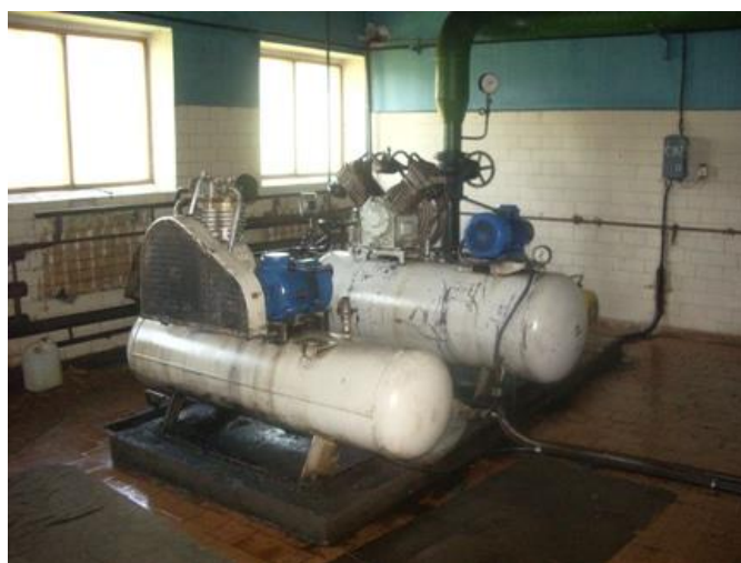
Рисунок 4.2.3.7 - Компрессорная станция для нагнетания воздуха
