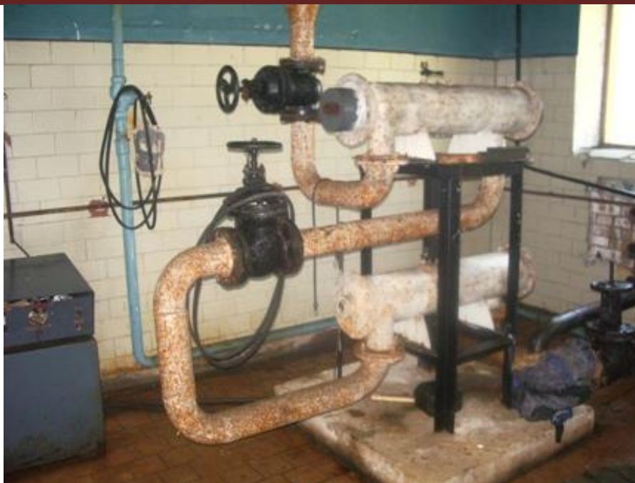
Рисунок 4.2.3.9 - Состояние блока УФ обеззараживания
